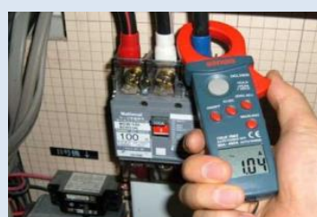
設備機械の電流測定
