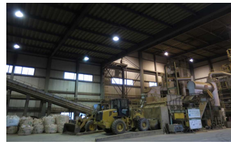
取替前(水銀灯)
