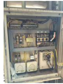
①既設シャッター配電盤
