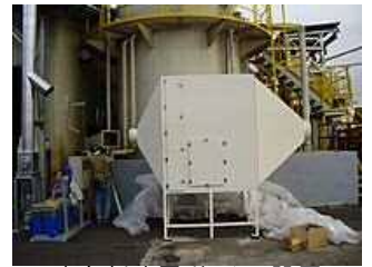
消臭剤噴霧ボックス設置
