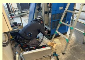
電源ケーブル接続等
