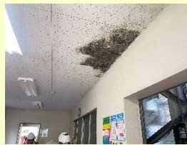
雨漏りによる腐食
