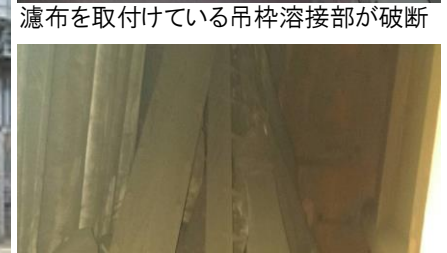
吊枠に負荷がかかって脱落している
